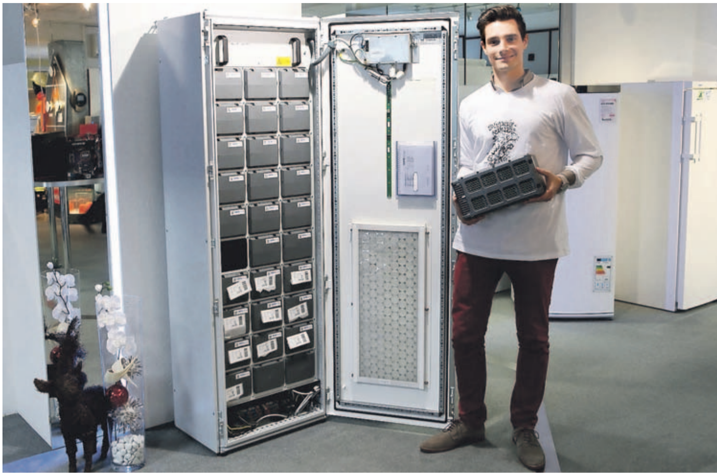
Fabian Brenner mit seinem Batteriespeicher
